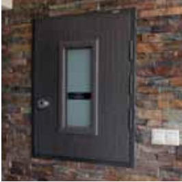
Absicherung eines Elektrizitätsmessers, Sicherheitsklasse 3 plus
